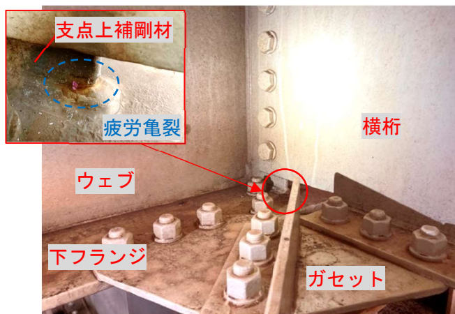
写真-1 亀裂発生箇所
