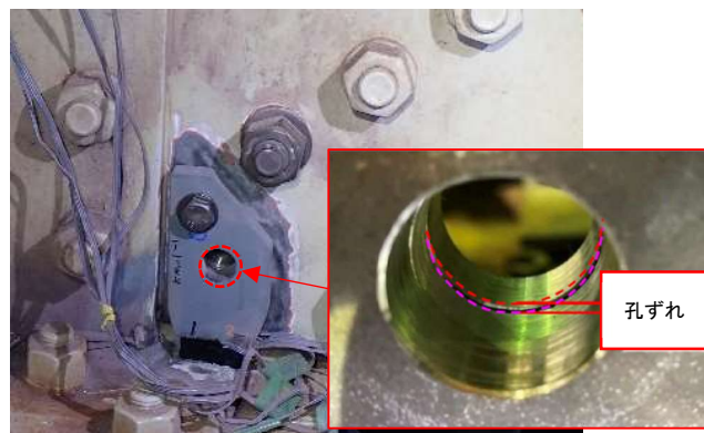
写真-3 当て板施工時の孔ずれ状況
