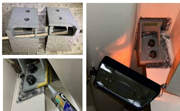
図-5 赤外線ヒーターでの保温対策
