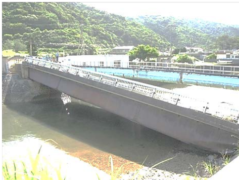
写真2 腐食による落橋事例 (沖縄県)
