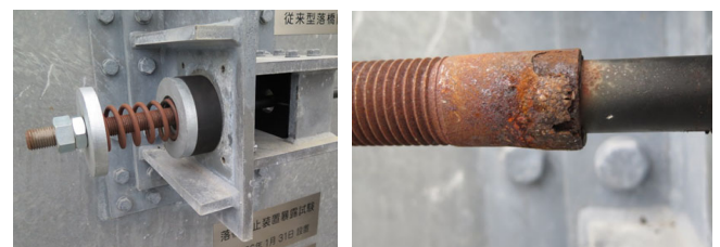
写真-7 従来型落橋防止装置の腐食状況
